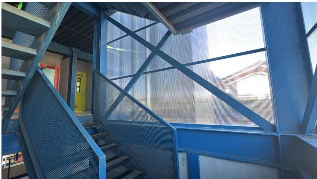
Protecciones cajas de escaleras y ascensor
