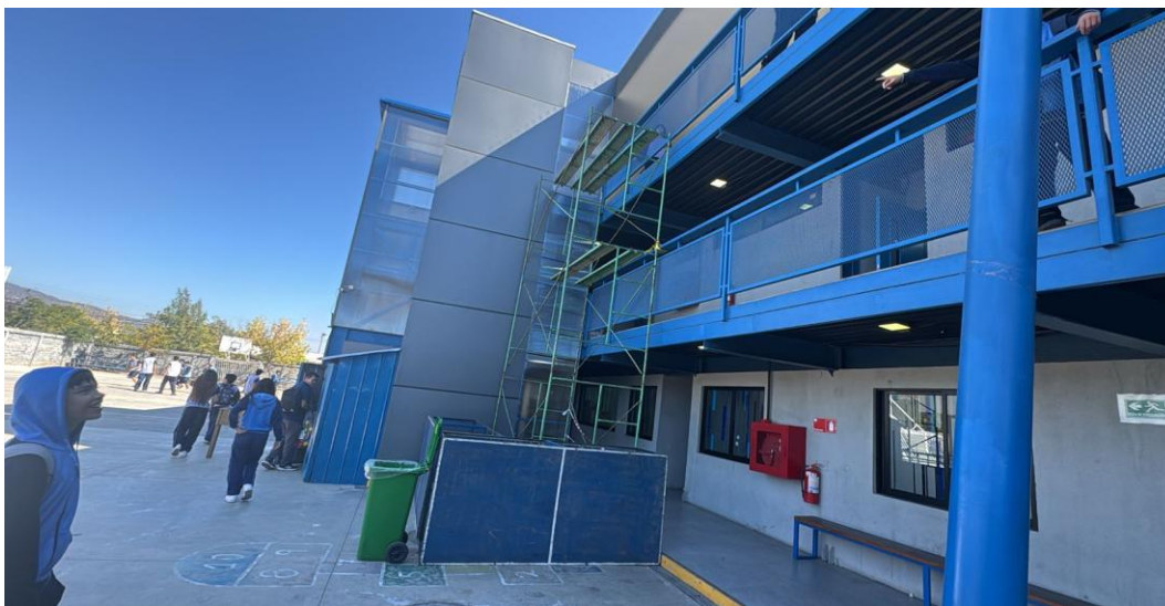
Protecciones cajas de escaleras y ascensor
